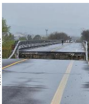
Il crollo del ponte sul Trigno
