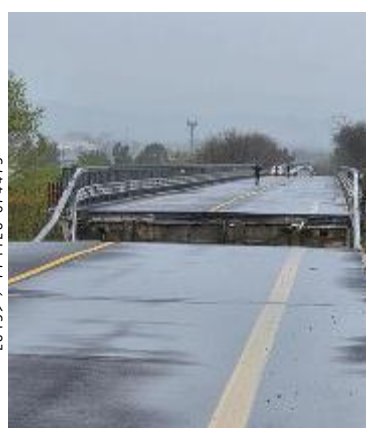
Il crollo del ponte sul Trigno
