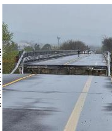
Il crollo del ponte sul Trigno
