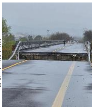
Il crollo del ponte sul Trigno
