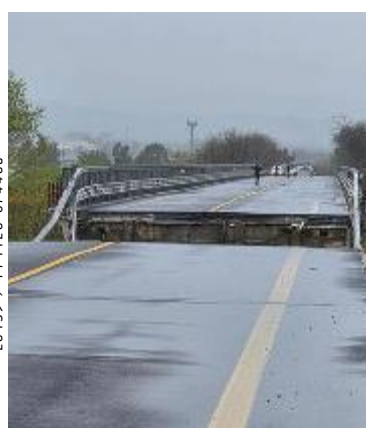
Il crollo del ponte sul Trigno
