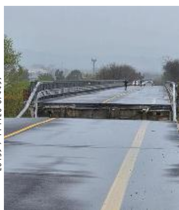
Il crollo del ponte sul Trigno
