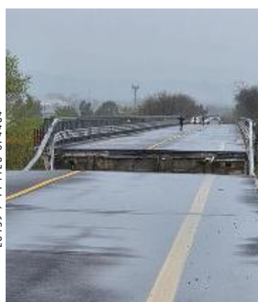
Il crollo del ponte sul Trigno
