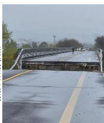
Il crollo del ponte sul Trigno
