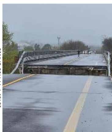
Il crollo del ponte sul Trigno
